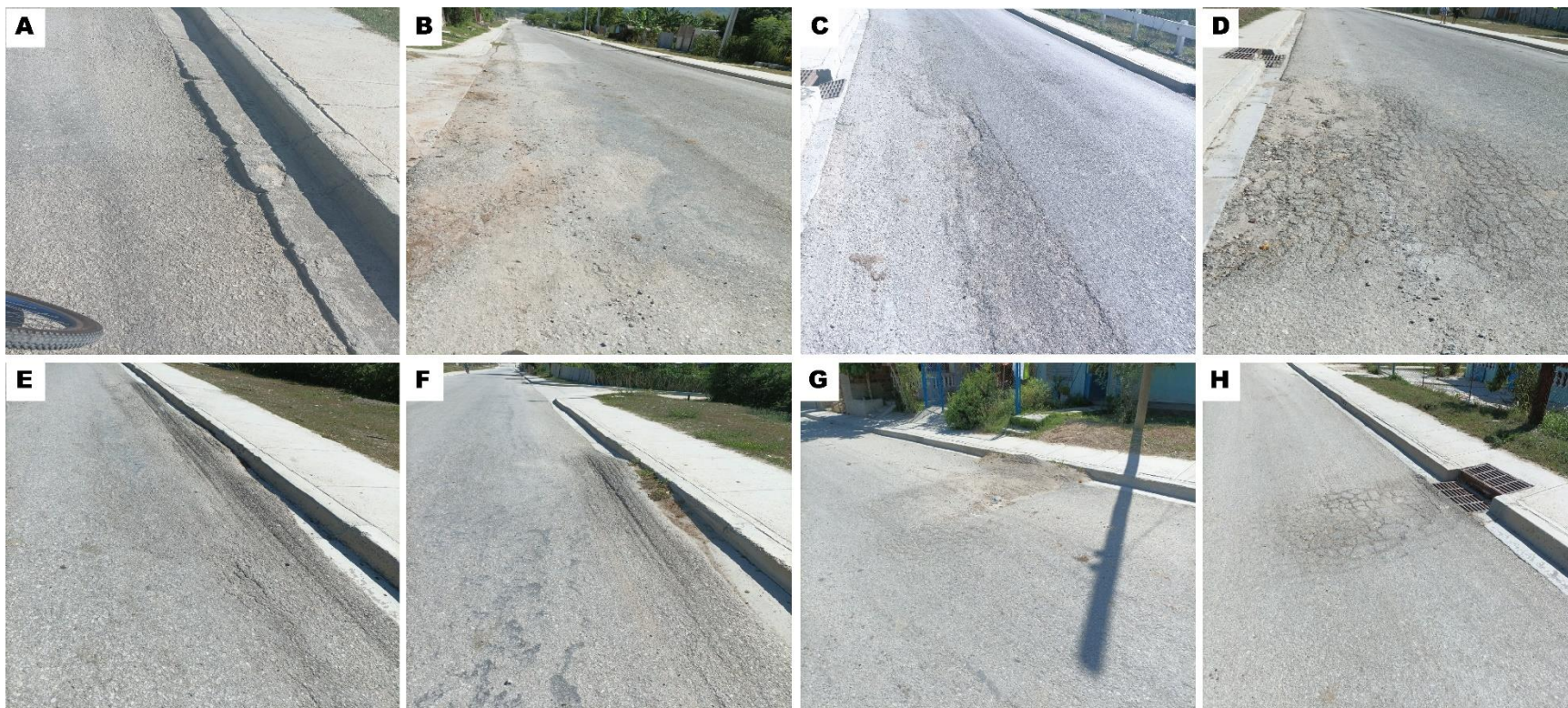
Figura 21. Lesiones detectadas en el vial Salaito. A) , Hundimiento. B) , Vertido de concreto en la vía, desprendimiento de agregados y huecos. C) , Desprendimiento de agregados. D) , Piel de cocodrilo. E) , Abultamiento, hundimiento y ahuellamiento. F) , Abultamiento, hundimiento ahuellamiento y exudación. G) , Abultamiento y hundimiento. H) , Agrietamiento en bloque.
