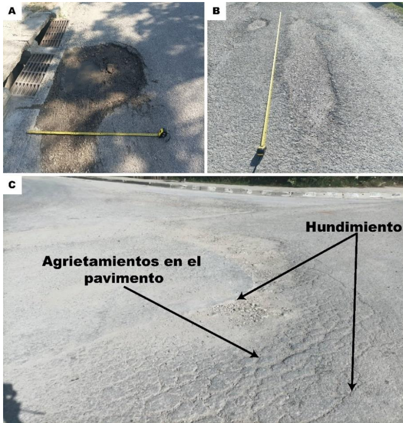
Figura 4. Lesiones observadas en el pavimento del vial Salaito. A) , y B) , Huecos o baches de distintos niveles de desarrollo. C) , Agrietamientos piel de cocodrilo, bacheo y hundimientos.
