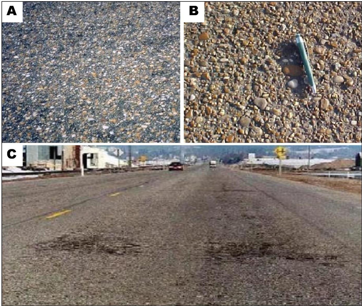
Figura 17. Meteorización. A) , Nivel de severidad L (Low-bajo). B) , Nivel de severidad M (Medium-medio). C) , Nivel de severidad H (High-alto). Fuente: Vásquez Valera (2002).
