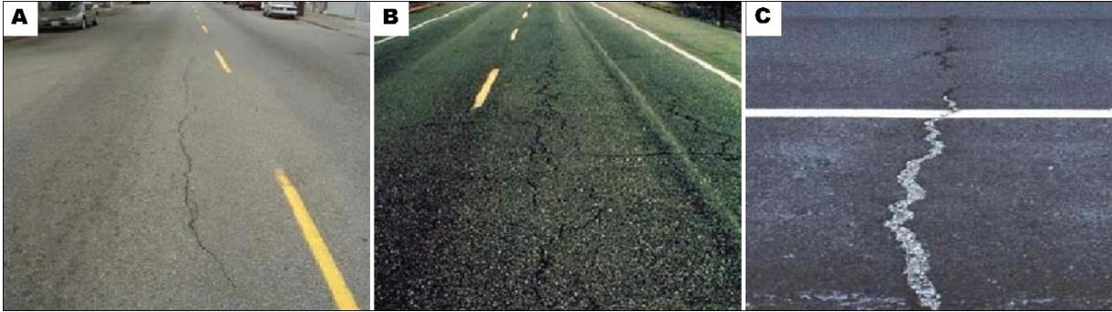
Figura 13. Grietas longitudinales y transversales. A) , Nivel de severidad L (Low-bajo). B) , Nivel de severidad M (Medium-medio). C) , Nivel de severidad H (High-alto). Fuente: Vásquez Valera (2002).
