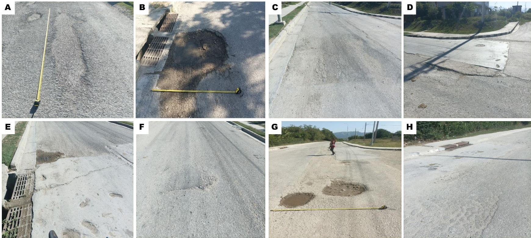
Figura 20. Lesiones detectadas en el vial Salaito. A), B), G), Huevo. C), Grietas longitudinales, parche de concreto y hundimiento. D), Parcheo, hundimiento. E), Parcheo, huevo y grieta transversal en losa de hormigón. F), Vertido de concreto en la vía, desprendimiento de agregados. H), Piel de cocodrilo y parche.
