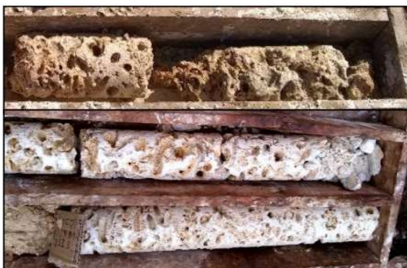
Figura 4. Oquedades observadas en los testigos de perforación.
