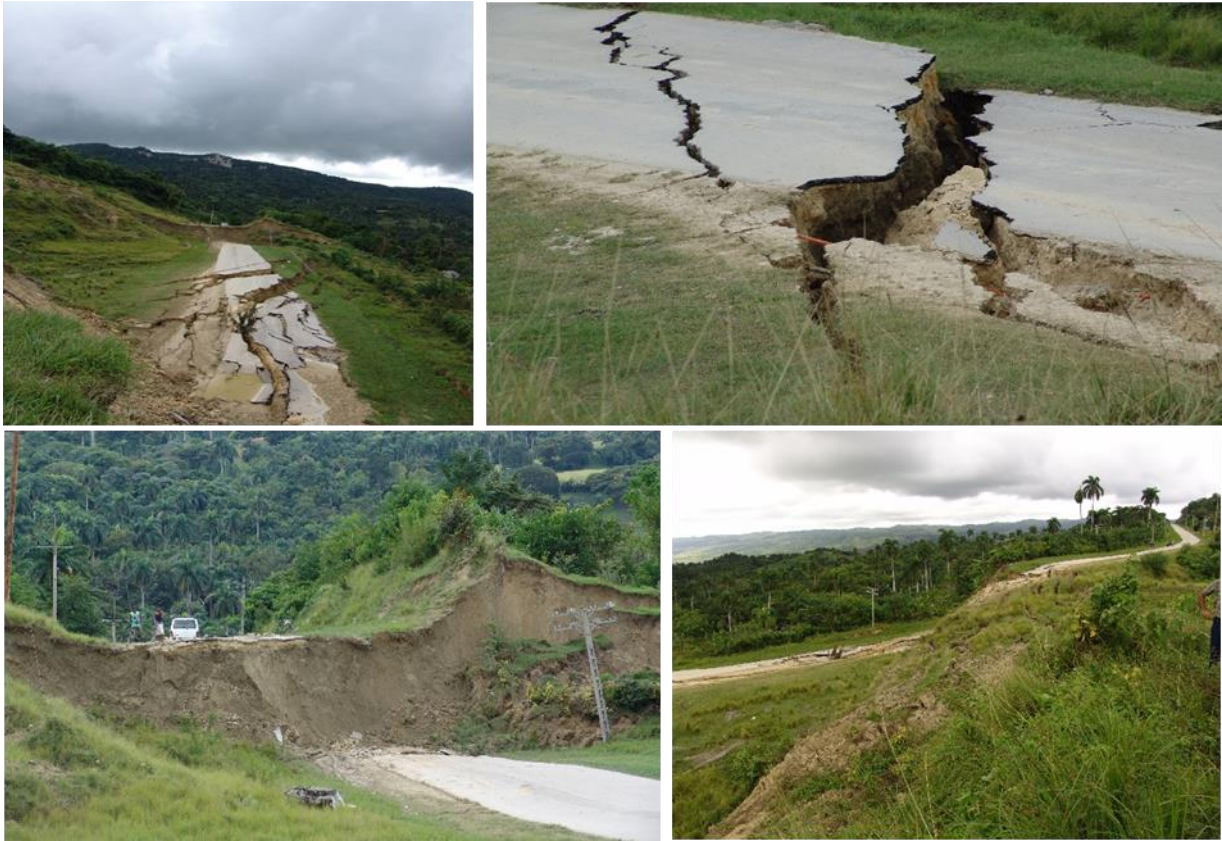
Figura 12. Deslizamientos en el municipio de Yateras, Foto 1: Deslizamiento del tramo de la carretera de La Güira a Boquerón; Foto 2: Destrucción de la carretera de La Güira a Boquerón por un deslizamiento; Foto 3: Escarpe principal del deslizamiento en el Zoológico de Piedra.
