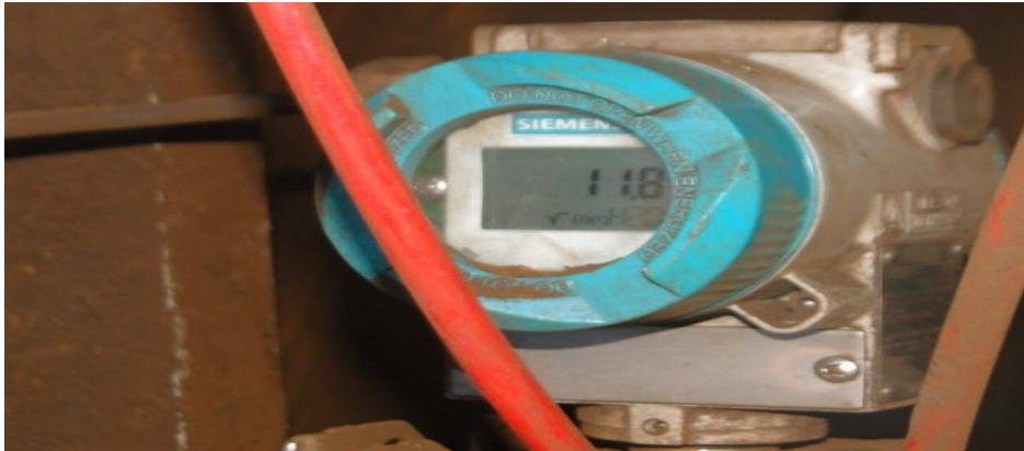
Figura 2.2. Medición de presión
