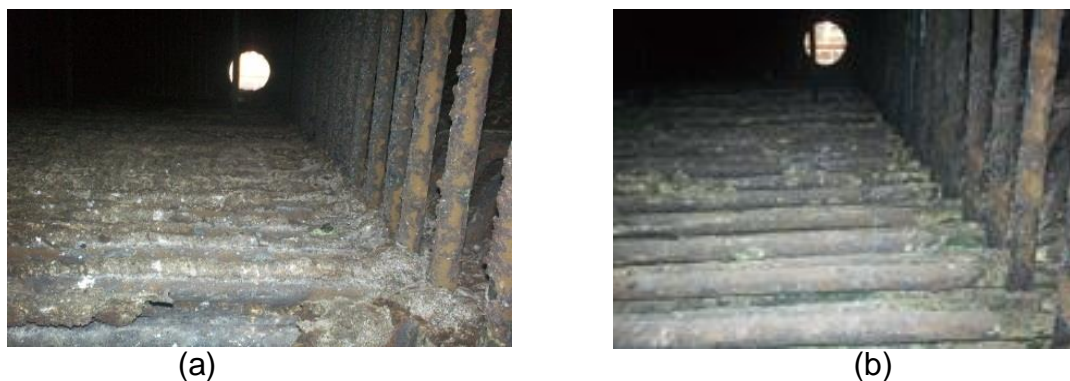
Figura 3.10 Calderas después de la prueba (a) y limpieza (b) con el aditivo PENTOMAG 4100.
