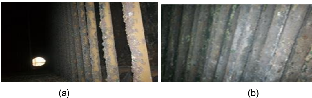
Figura 3.4 Calderas después de la prueba (a) y limpieza (b), con el uso del aditivo PICIZ 4804.
