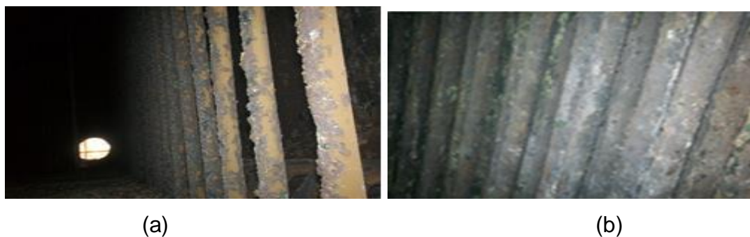
Figura 3.11 Calderas después de la prueba (a) y limpieza (b), con el uso del aditivo PICIZ 4804
