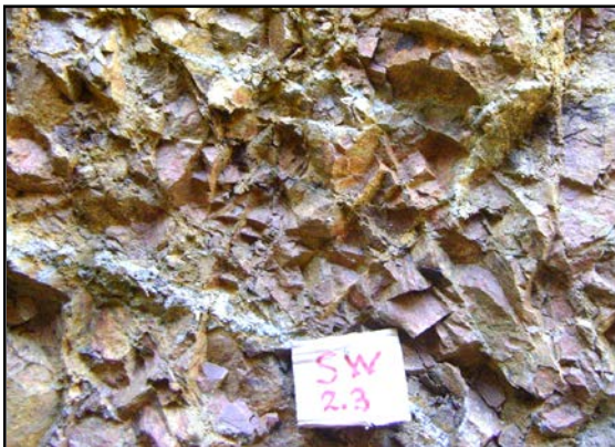
Fig. No. 36. Intervalo entre 2.00 y 2.30 m. Se observa el intenso agrietamiento.
