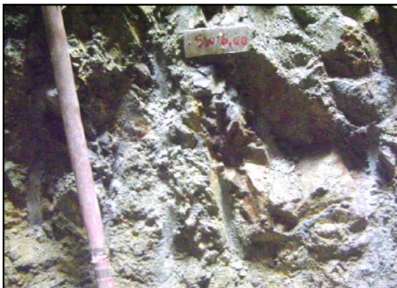
Fig. No. 37. Intervalo a los 6.00 m de profundidad. Continúa el agrietamiento.
