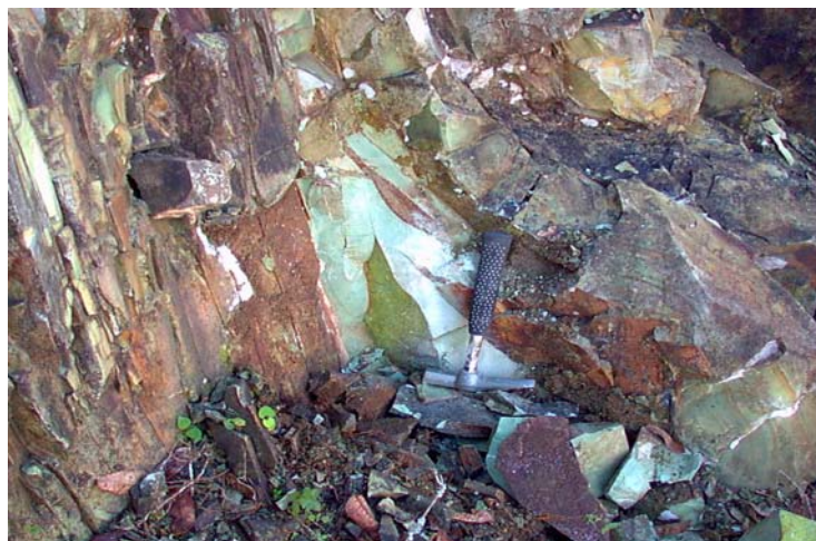
Figura II.2 Base del talud; se observa el típico color verde de las rocas y grietas rellenas por óxidos de hierro
