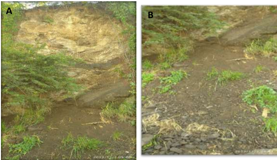
Figura 28. A) Talud de 30 metros de altura. B) Acumulación de sedimentos.
