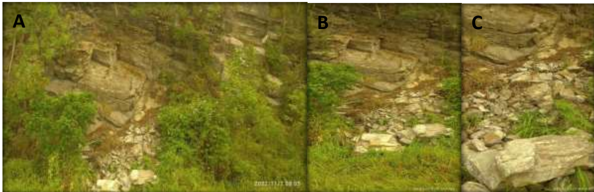
Figura 20. Movimiento de bloques rocosos. B) y C) Material desprendido.
