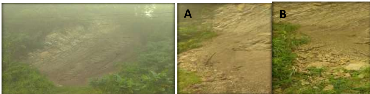
Figura 14. Talud con altura aproximada de 50m de alto y 40m de largo. A) y B) Acumulación de sedimentos en la base del talud.
