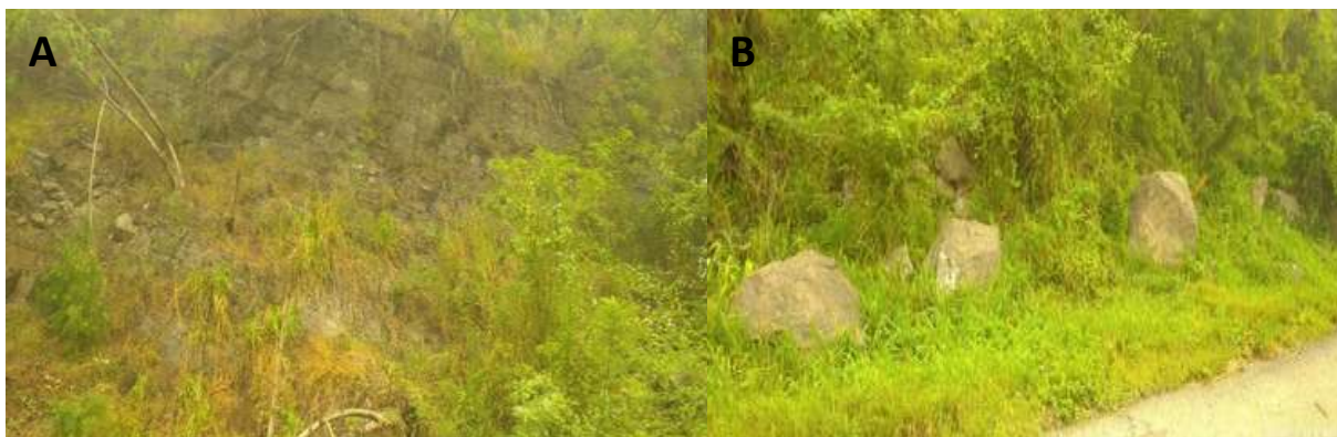
Figura 22. A) Talud de 40 metros de altura y 20 metros de superficie B) Bloques desprendidos.
