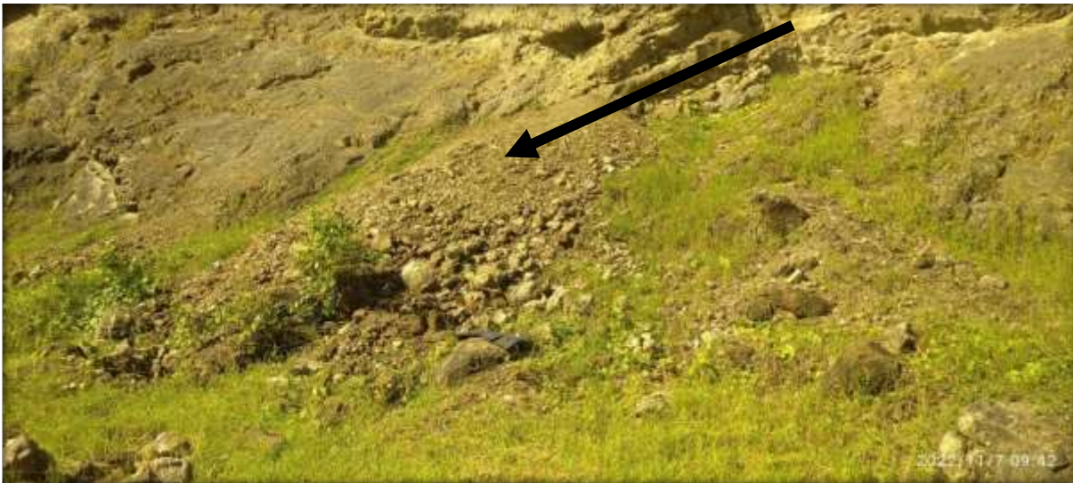
Figura 29. Acumulación de pequeñas rocas y sedimentos productos de los desprendimientos.
