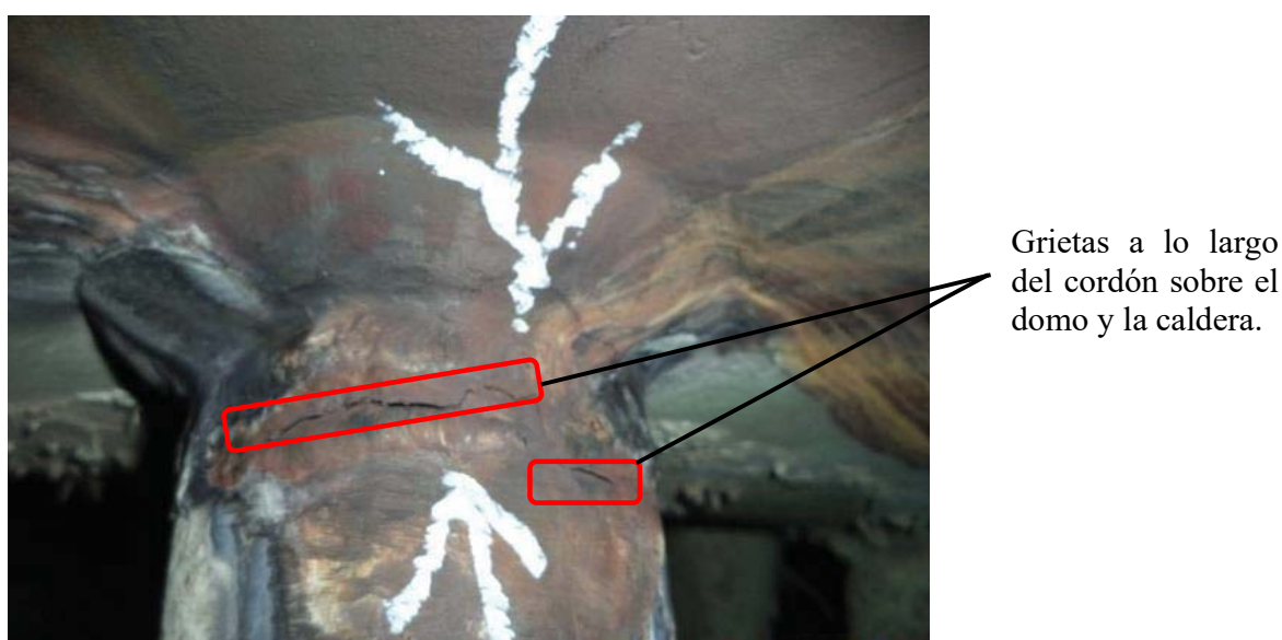
Figura 2.1. Zona agrietada en el domo de la caldera.
