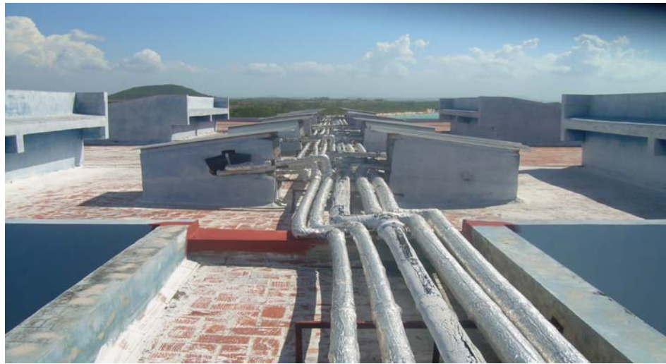
Fig. 2.6 Red de tuberías en malla del CSAF de la edificación.
