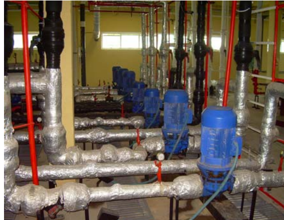
Fig. 2.4 Bombas del Circuito Secundario de Agua Fría.
