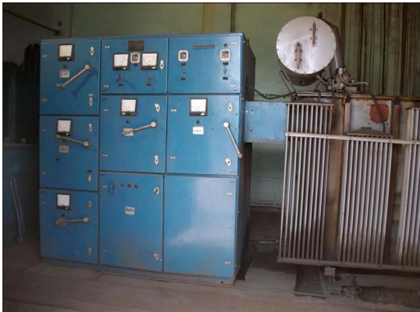
Figura 2.1b Subestación de amoníaco de la Empresa Puerto Moa
