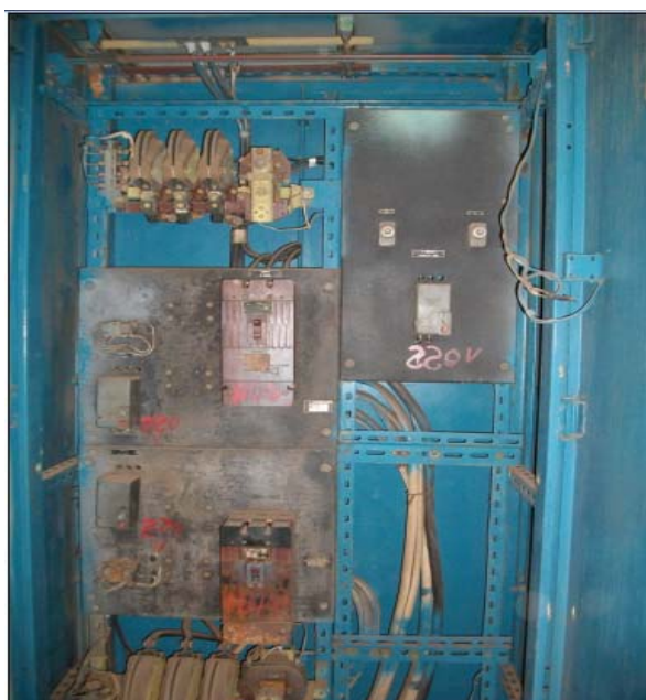
Figura 2.1e Interruptores instalados en 1W2
