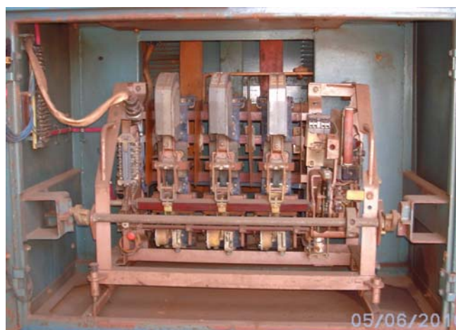
Figura 2.1d Interruptor de entrada en la PGD de la subestación de amoníaco
