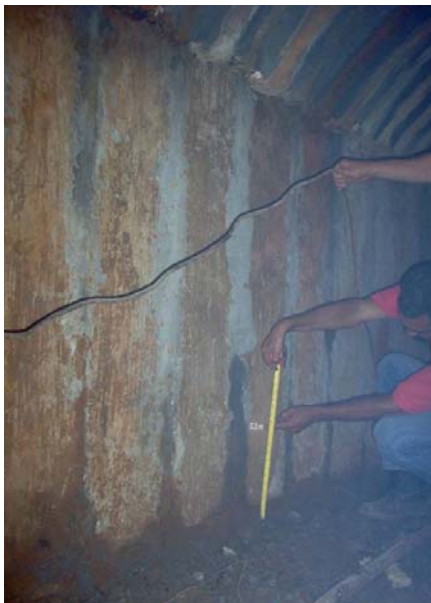
Fig. # 3 Nivel alcanzado por el agua
