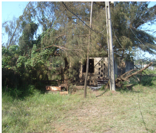
Casa de bombas
