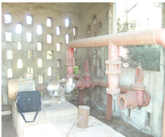
Sistema de bombeo quebrantado
