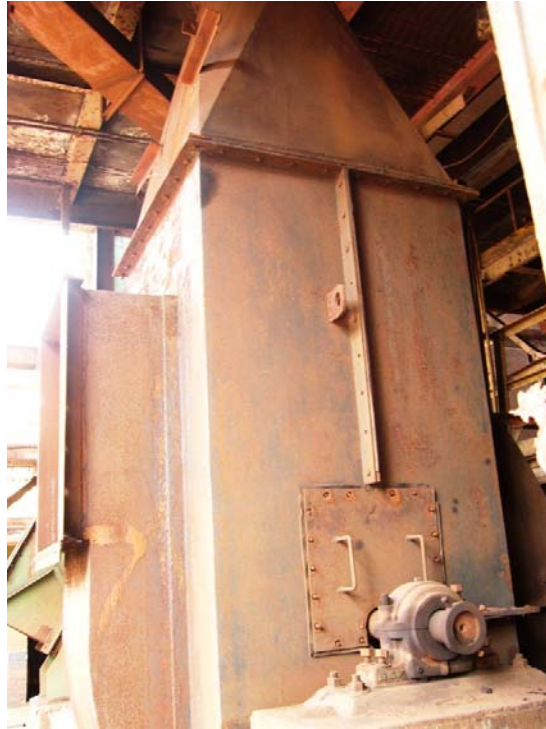
Figura 1.1. Ventilador centrífugo empleado en la UEB Recuperación - Sínter
