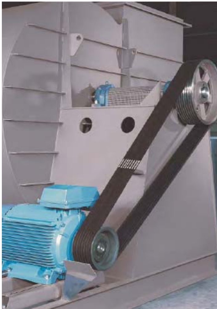
Figura 1.4 El accionamiento electromecánico del ventilador centrífugo
