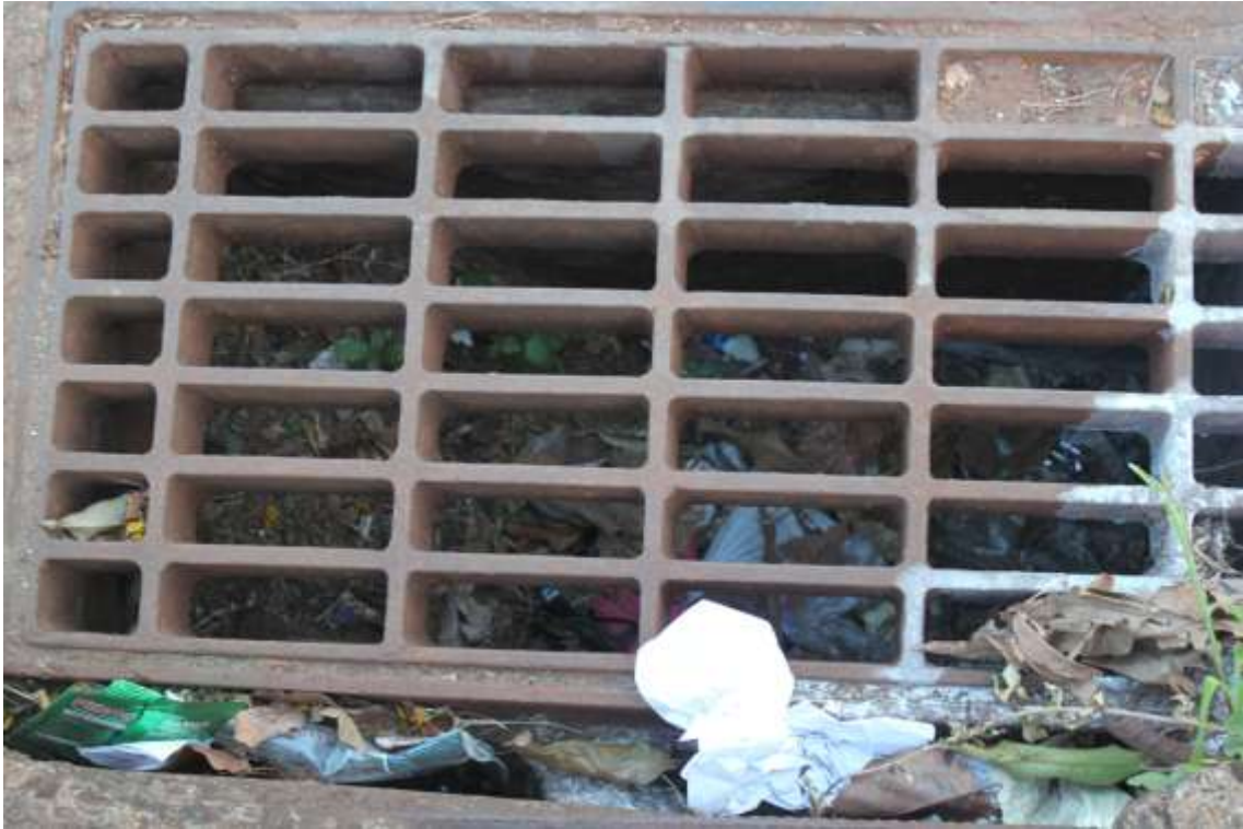
Foto Nº 5. Colectores de aguas pluviales con acumulación de residuales sólidos, lo cual limita su uso.
