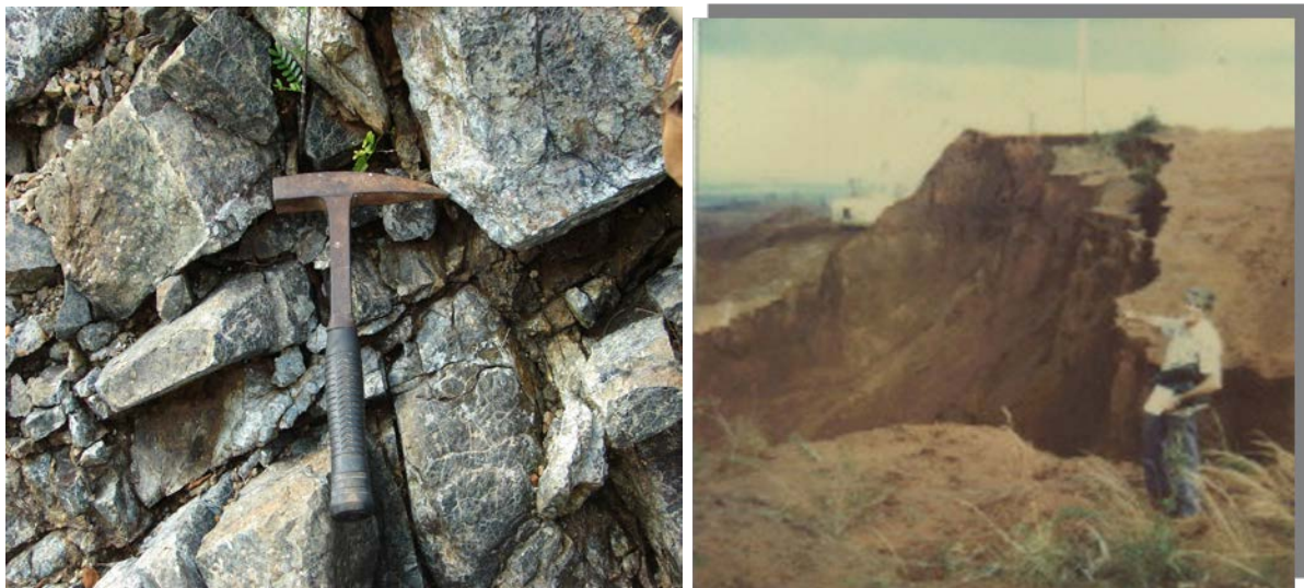
Figura 10. Cortes en rocas serpentinizadas y cortezas de meteorización, sismo de diciembre 1998 en Moa.
