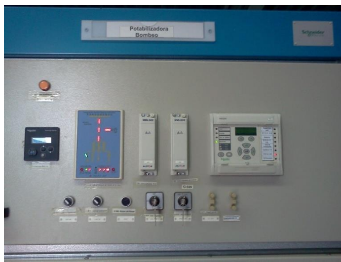
Fig. 4. Foto del sistema de control y señalización de un interruptor de línea.
