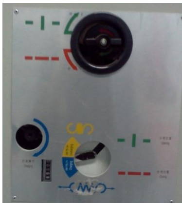
Fig. 15. Foto de la parte frontal del armario hermético donde se encuentra el mecanismo de operación manual
