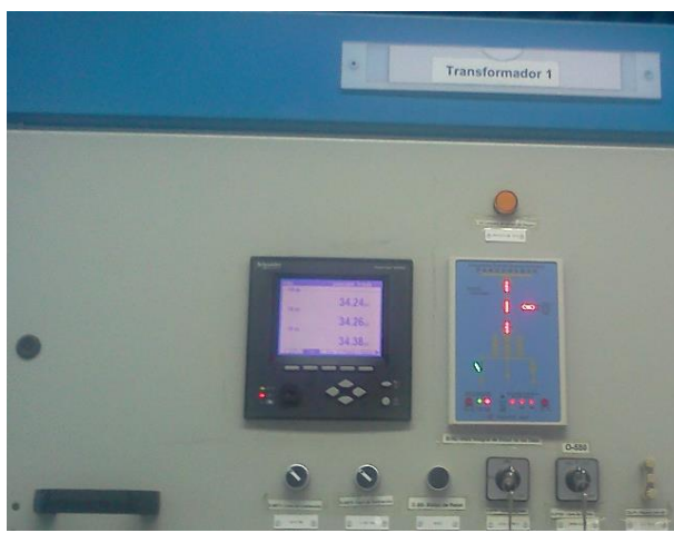
Fig. 5. Foto del sistema de control y señalización del totalizador T1
