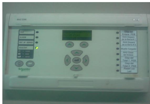
Fig.9. Foto del Relé de sobrecorriente P143
