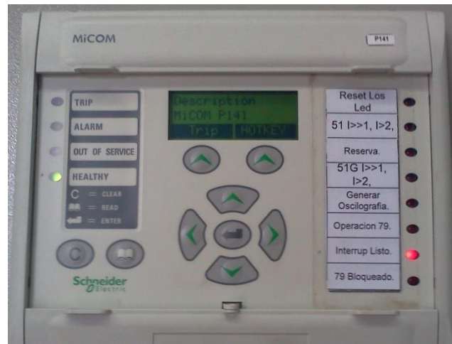
Fig. 8. Foto del Relé de sobrecorriente P141
