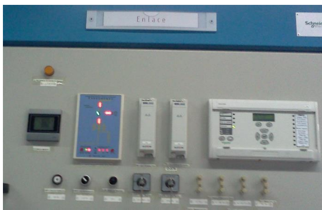
Fig. 6. Foto del sistema de control y señalización del enlace de barras.
