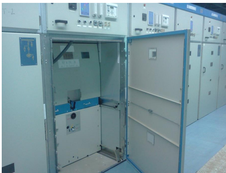
Fig. 2. Foto de una celda de los interruptores a 34,5 kV
