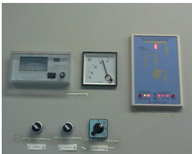
Fig. 3. Foto del sistema de control y señalización del TP de barra 1.
