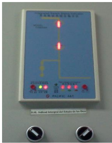
Fig. 7. Foto del sistema de señalización del acople de barras
