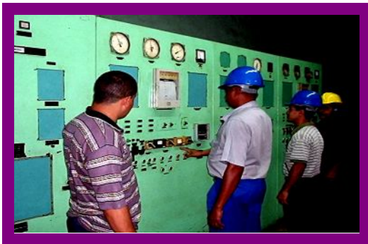
Figura: 3.4 Foto del panel de control de los compresores.
