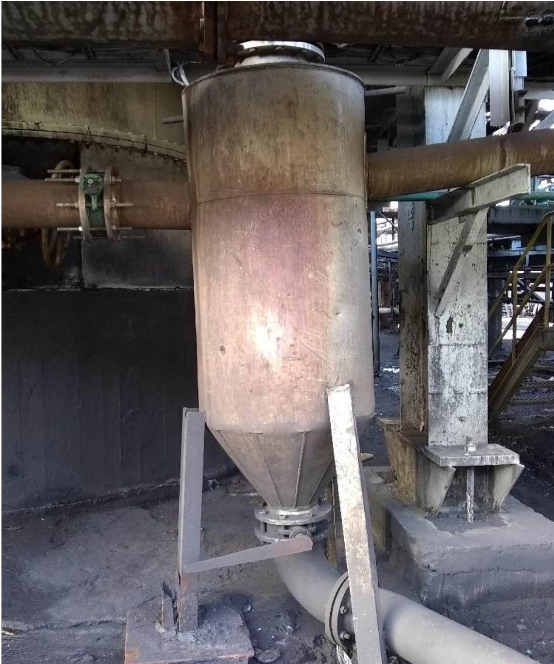
Figura 2.2. Tanque separador de partículas.
