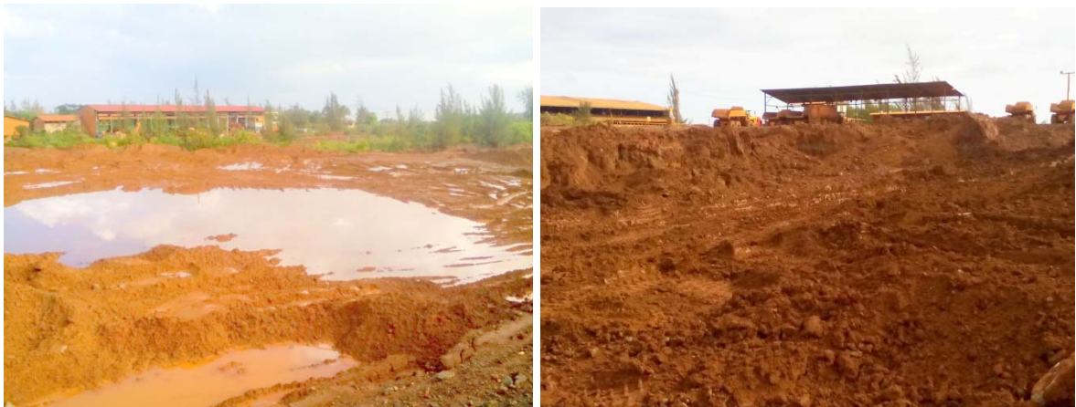
Figura 3.10 y 3.11. Depresiones provocadas por la mala operación de los operadores de los cargadores y retroexcavadoras al minar.
