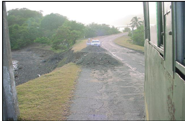
Figura 3.14. Foto socavación de la carretera por el deslizamiento del talud.
