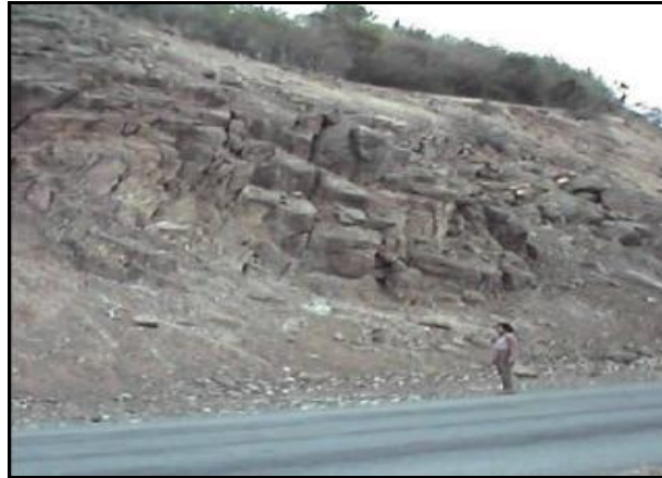
Figura 3.22. Foto talud el Papayo, secuencias de composición vulcanógeno sedimentarias estratificadas, con planos de discontinuidades favorables al ángulo del talud.
