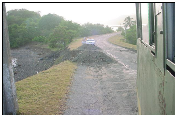
Figura 3.21. Foto socavación de la carretera por el deslizamiento del talud.
