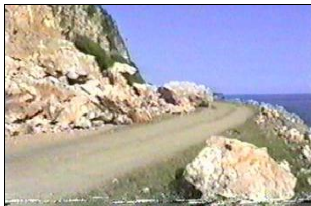
Figura 3.19. Foto deslizamiento ocurrido en el año 1997.
