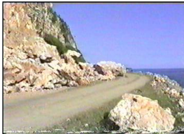
Figura 3.12. Foto deslizamiento ocurrido en el año 1997.
