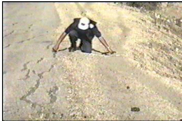
Figura 3.4. Foto Grietas en la carretera producto al deslizamiento del talud Sur.
