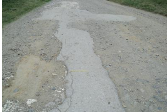
Foto No 5. Deterioro de la SUPERFICIE Desprendimientos (Pérdida de la Capa de Rodadura)
