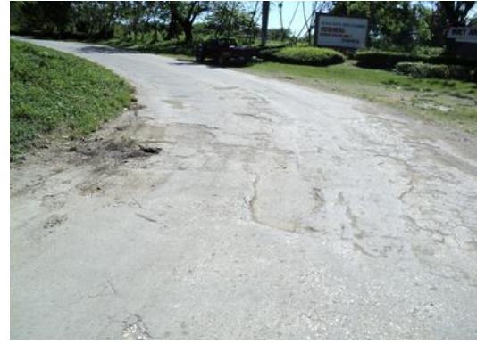
Foto No 6. Deterioro de la ESTRUCTURA Deformaciones (Ondulaciones)
