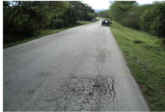
Foto No 2. Deterioro de la ESTRUCTURA
