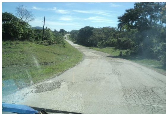
Foto No 9. Deterioro de la ESTRUCTURA Agrietamiento (Piel de Cocodrilo)
