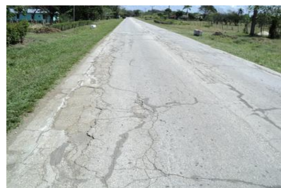
Foto No 4. Deterioro de la ESTRUCTURA
