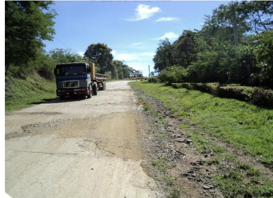
Foto No 8. Deterioro de la SUPERFICIE Desprendimiento (pérdida de la capa de rodamiento)
