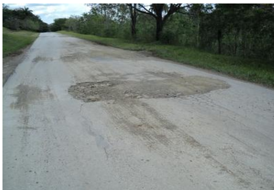
Foto No 3. Deterioro de la ESTRUCTURA
