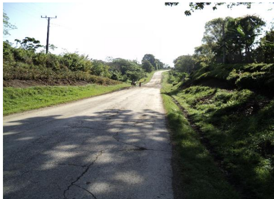
Foto No 7. Deterioro de la ESTRUCTURA Agrietamiento (grietas longitudinales y transversales)
