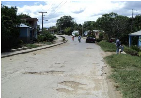
Foto No 1. Deterioro de la SUPERFICIE
