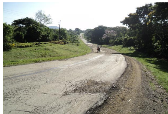
Foto No 10. Deterioro de la ESTRUCTURA Agrietamiento (Piel de cocodrilo)
