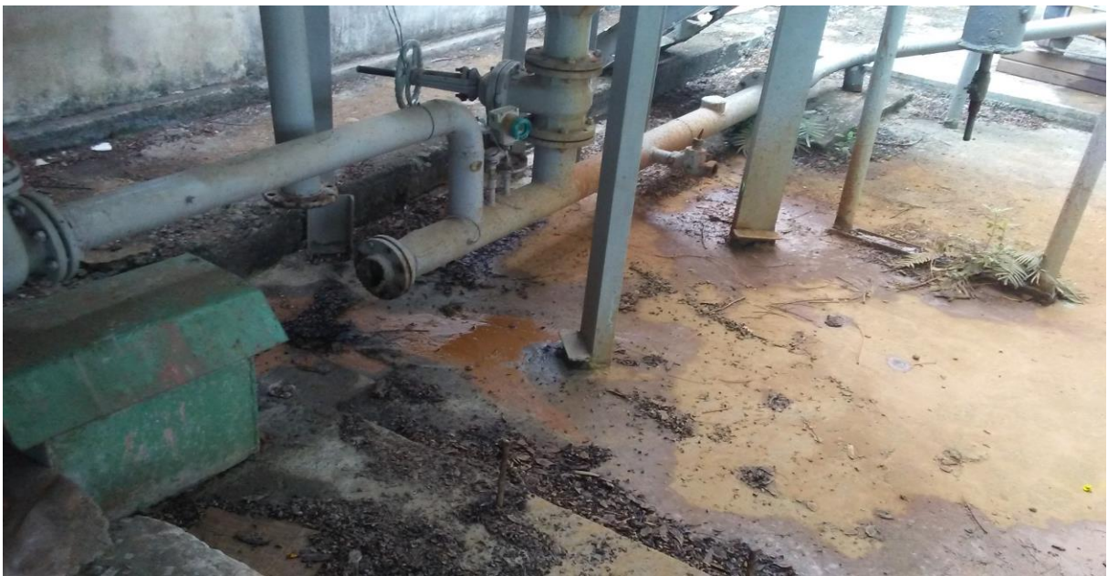
Figura 3.6. Derrame de pulpa laterítica.
